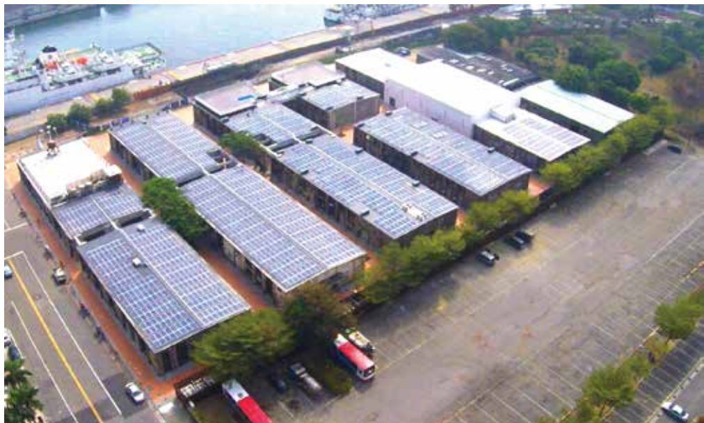
展演設施類建築：駁二藝術特區（678.63 kWp）
